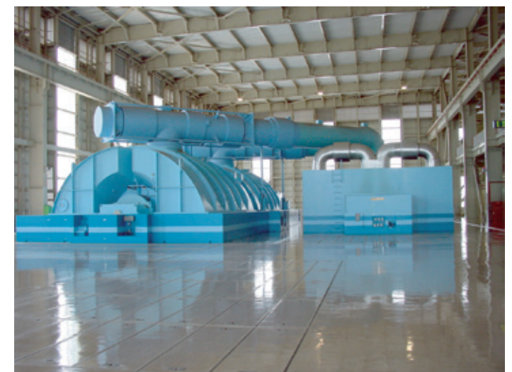
100万キロワットのタービン発電機は 最高水準の効率を追求 環境対策も徹底
