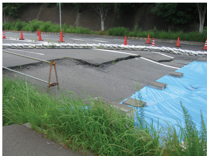
道路の陥没も至るところに発生した(7月2日撮影)
