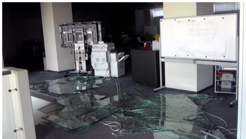
ガラスが割れた茨城オフサイトセンター内 （検査官事務所より提供いただいた、3月12日撮影）
