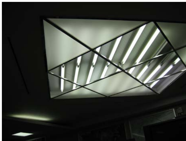
破損し蛍光灯がむき出しになった災害対策本部の照明 (12月21日撮影)
