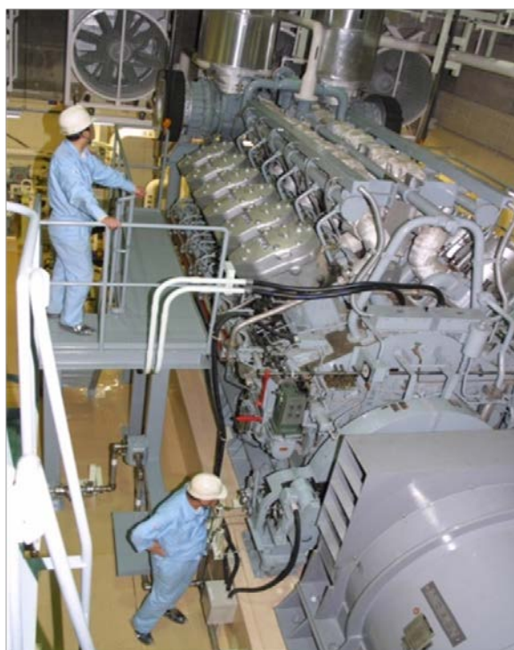
約50時間電力を供給し続けた非常用発電機 今後燃料備蓄を増やす予定 (写真提供：日本原子力研究開発機構)
