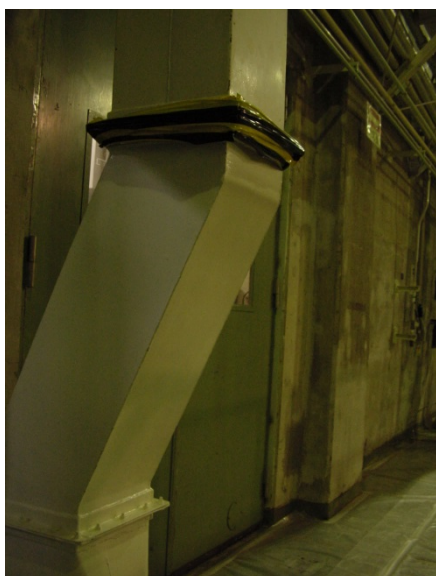
問題あり：通路に張り出したダクト（指摘後、注意喚起のテープが貼られた）
