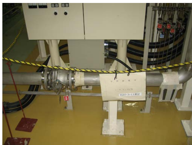
周囲と比較してやや放射線量が高い場所には、自主的な注意喚起としてトラロープと表示を設置 視察時の質問をきっかけに表示が見直され、施設の他の場所の表示も統一された
