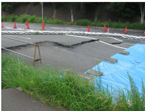
道路の陥没も至るところに発生した(7月2日撮影)
